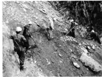
原住民族協同維護計畫-災害後進行緊急搶修維持步道暢通 (玉管處提供)
